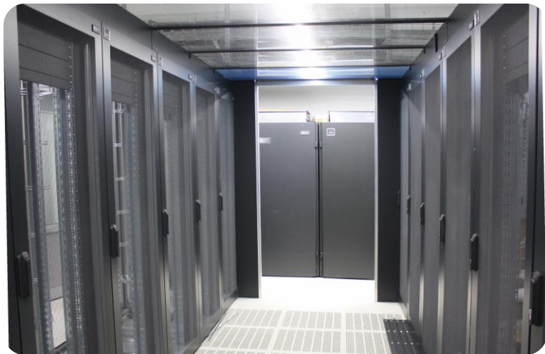
СОЗДАНИЕ ЦОД TIER III ДЛЯ ХОЛДИНГА «СБИС ТЕНЗОР» НА БАЗЕ IBM
